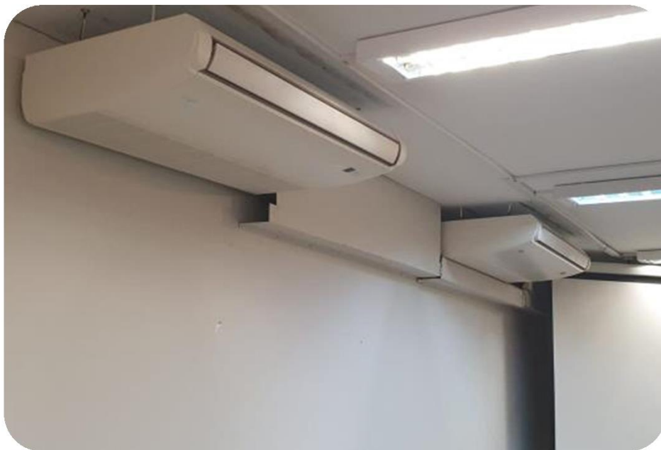
FOTO 3: Imagem dos dois Split instalados na sala de aula FA-14, com capacidade de 36.000 BTU/h e tecnologia Inverter, que garante maior eficiência energética e climatização estável. Na referida sala foram instalados dois equipamentos de igual capacidade e característica.
