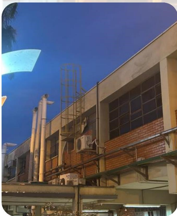
FOTO 5: Escada marinho instalado no prédio do DEPAN/DECAN.
