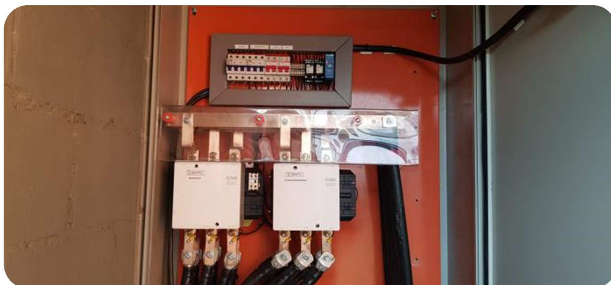
FOTO 4: DETALHE DO QUADRO DE COMANDO QTA.
