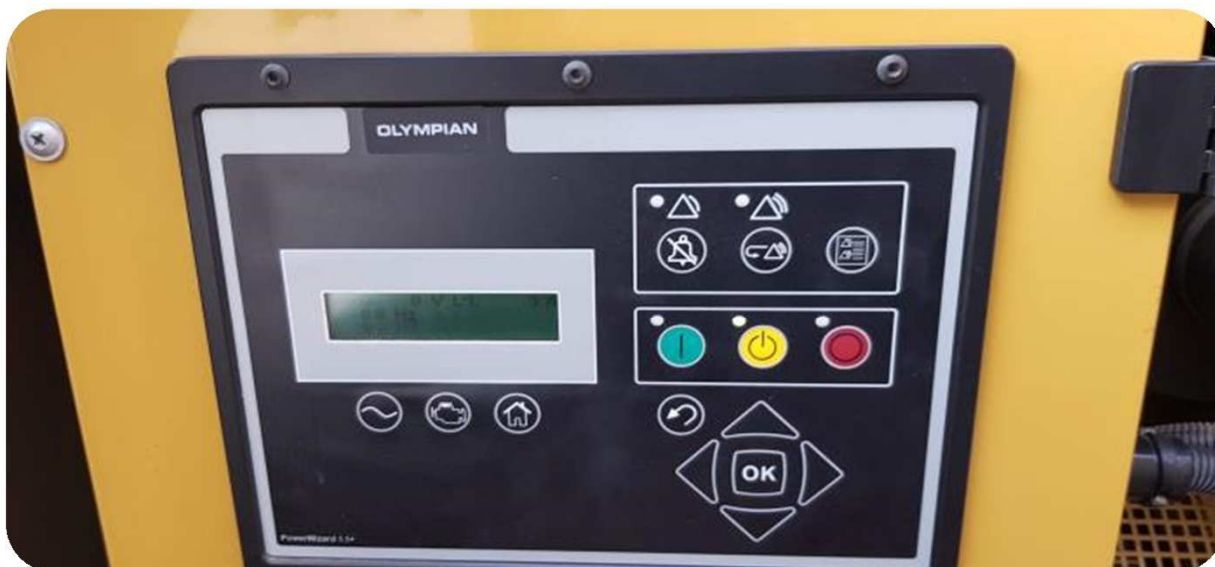
FOTO 3: DETALHE DO QUADRO DE COMANDO INTERNO DO GERADOR DE ENERGIA.
