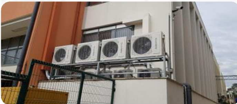
FOTO 14 - DETALHE DAS CONDENSADORAS INSTALADAS NO LADO EXTERNO DO PRÉDIO.
