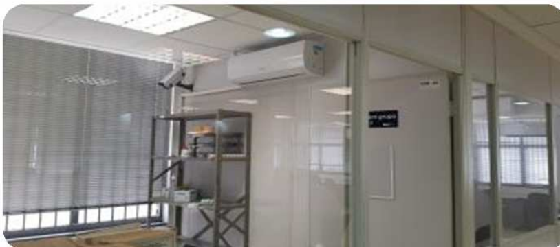
FOTO 11 - DETALHE DOS SPLITS INSTALADOS NAS SALINHAS DA BIBLIOTECA
