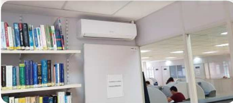
FOTO 13 - DETALHE DOS SPLITS INSTALADOS NAS SALINHAS DA BIBLIOTECA
