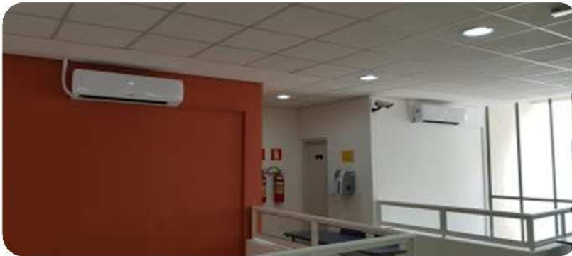
FOTO 12 - DETALHE DOS SPLITS INSTALADOS NAS ÁREAS COMUNS DA BIBLIOTECA
