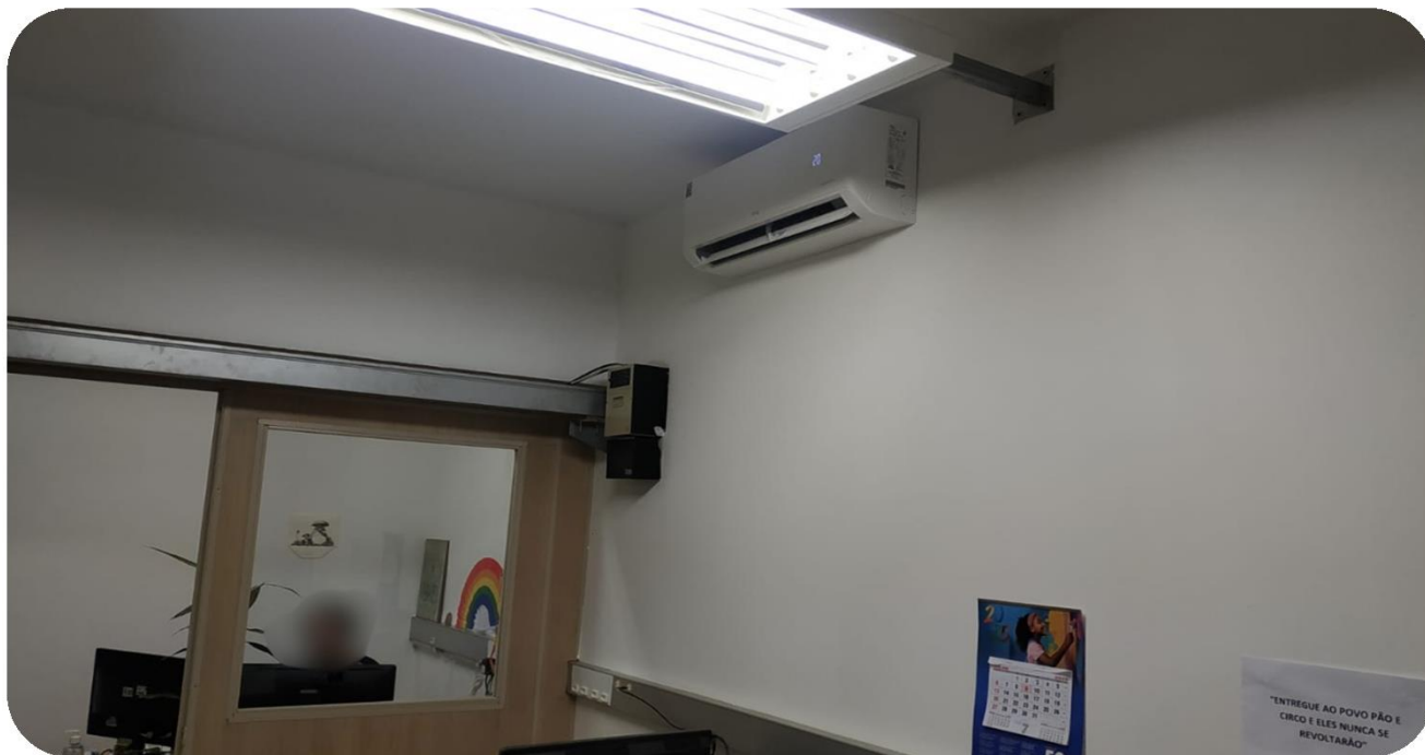
FOTO 4: Na imagem estão destacadas as infraestruturas executadas para adequar o espaço, tais como: climatização, iluminação, elétrica e de dados.
