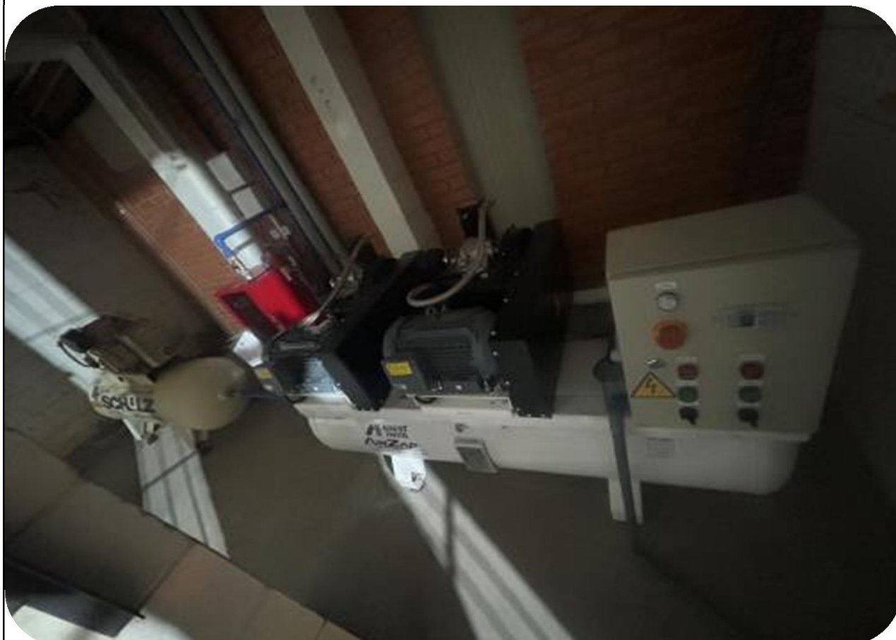
FOTO 1: Em destaque na imagem o novo compressor adquirido. Descrição: Equipamento isento de óleo tipo scroll SLT10D - Secador de ar HB DPR 036 com filtro de ar coalescentes HB A2 030G.
