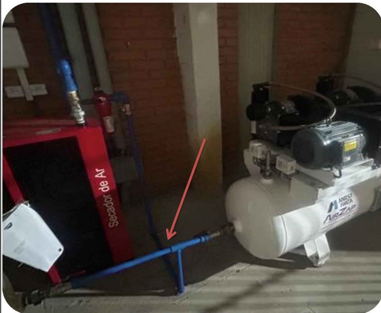
FOTO 4: Em destaque na imagem a interligação dos dois compressores que, conforme explicado na foto anterior, garante maior robustez no sistema de geração de ar comprimido para a Planta Piloto do DEA/DETA.
